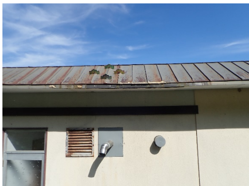
図 1 屋根材の腐食・変形
