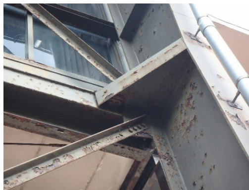
図 2 鉄骨部材の腐食
