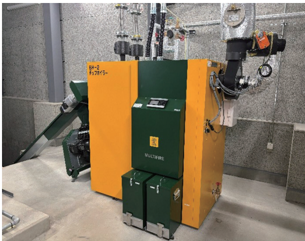
<木質バイオマスボイラー>
