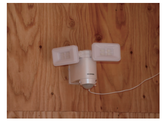
↑備蓄庫の中にもライトを備え付けています。
