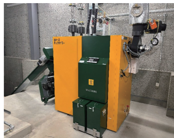
<木質バイオマスボイラー>
