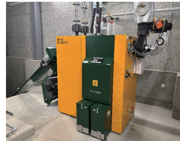
<木質バイオマスボイラー>
